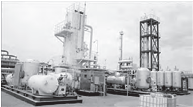
Рис. 1. Завод по сжижению природного газа (г. Новокузнецк) / Fig. 1. Natural gas liquefaction plant (Novokuznetsk)
