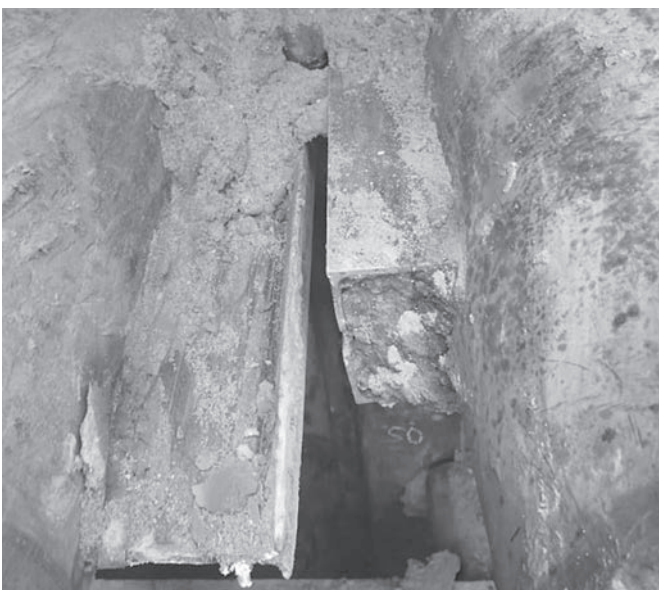
Рис. 10. Расстыковка замков смежных труб защитного экрана / Fig. 10. Disengagement of the locks on adjacent pipes of the pipe-roof
