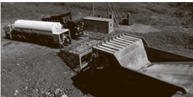
Рис. 3. Заправочная площадка сжиженного природного газа на участках горных выработок угольного разреза в Кузбассе / Fig. 3. LNG refueling site at the mining sites of a coal mine in Kuzbass
